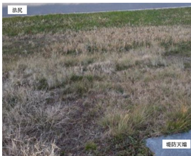
図 4.1-6 堤防法面における植生の繁茂状況
