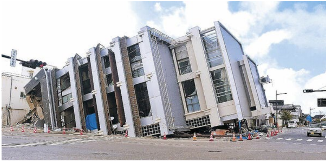
図 2.7-2 石川県輪島市にて鉄筋コンクリート造のビルが倒壊した様子 出典：北國新聞 DIGITAL 28)
