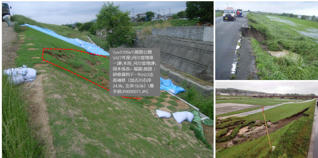
図 2.2-2 堤防法面の変状事例：平成 30 年国土交通省資料より 15)
