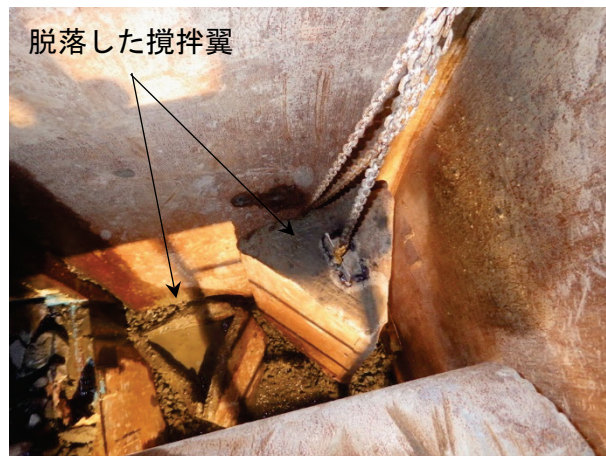
写真-5.20 攪拌翼脱落状況
