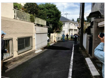
写真-1.1 道路陥没状況(1) 6)
