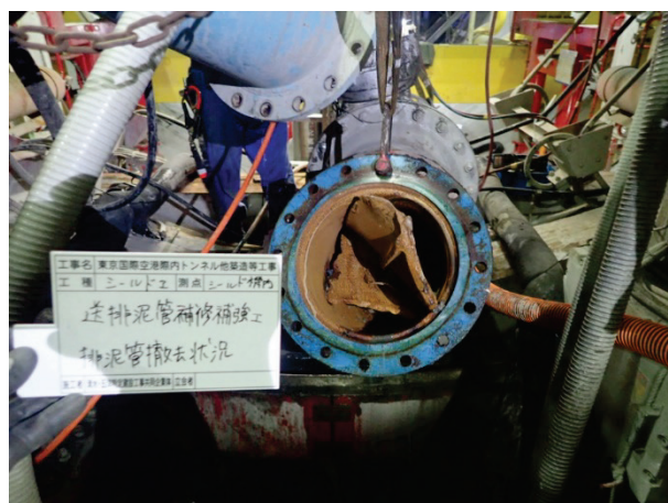
写真-5.23 排泥口付近閉塞状況
