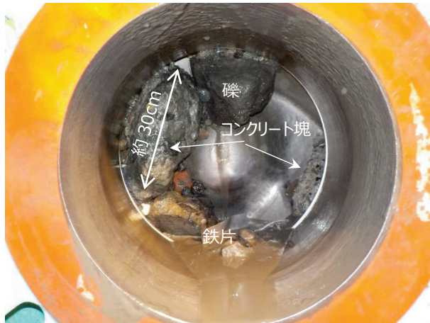
写真-5.12 排泥ポンプ閉塞状況
