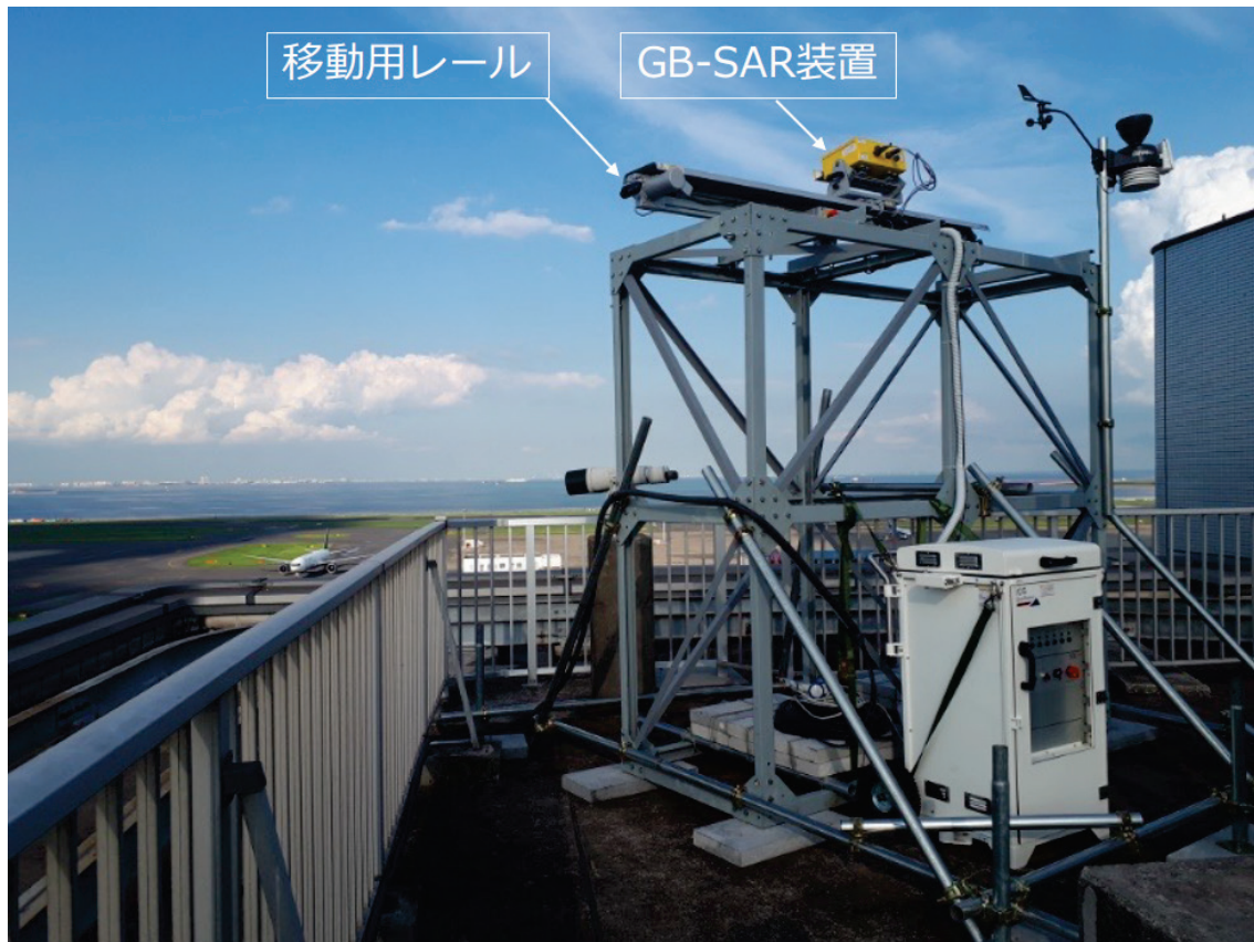
写真-5.1 高層ビル屋上に設置したGB-SAR装置
