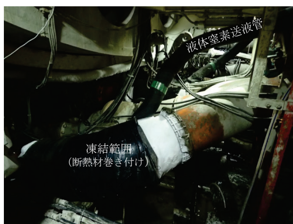
写真-5.22 排泥管（φ350mm）凍結状況
