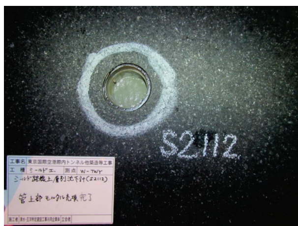
写真-5.9 観測孔の閉塞
