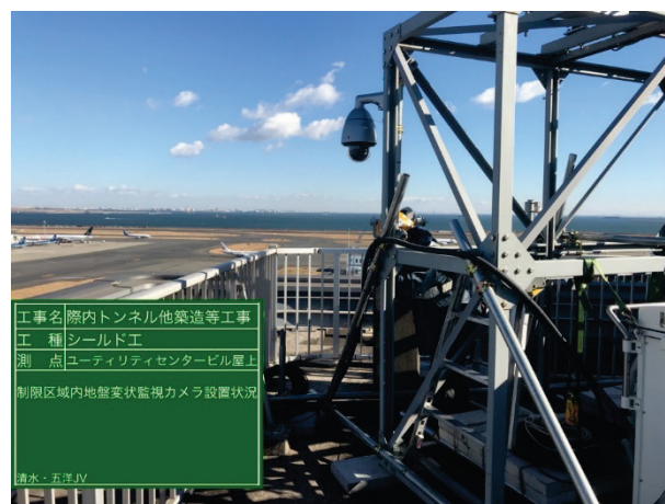
写真-5.10 高感度望遠カメラ設置状況
