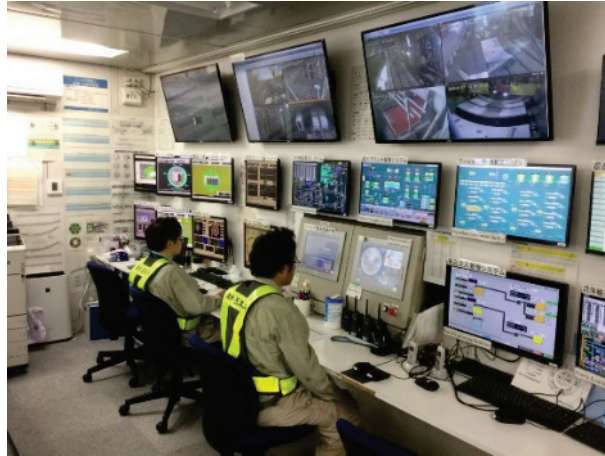
写真-5.11 監視状況（中央制御室）
