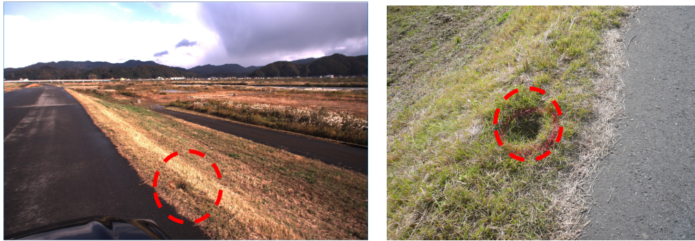
図 9(2) ヌートリア巣穴（左：MMSに搭載したデジタル画像 右：現場写真）
