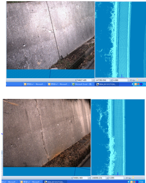
図 17 堤防の目地（上）、クラック（下）のデジタル画像
