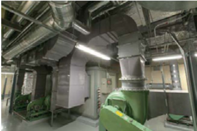
図—4 光触媒脱臭装置
