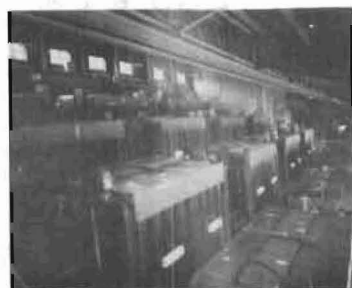
写真4-4-5 イオン膜法採かん設備（電槽室）
