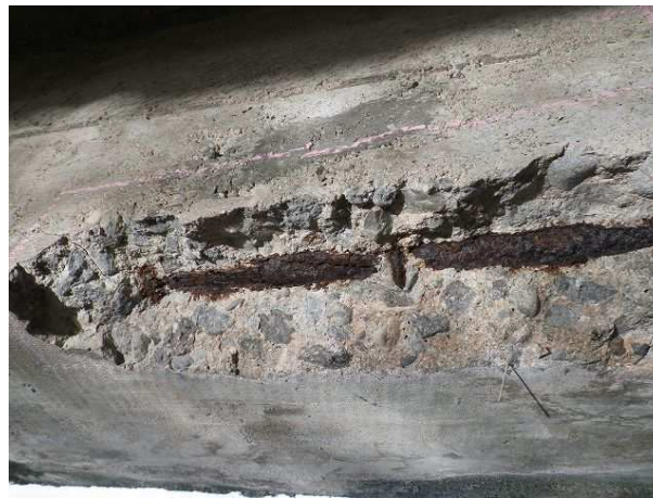
写真 2.3-1 塩害による劣化が生じた構造物
