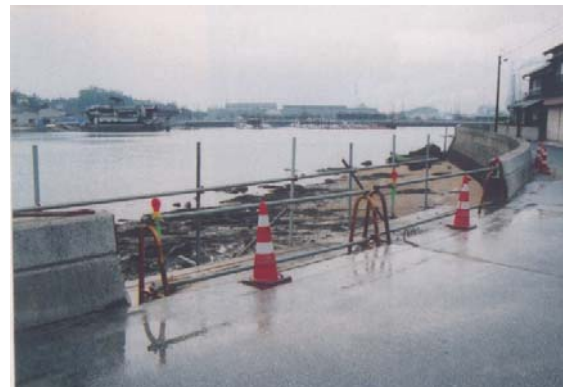
図11 台風18号による勇崎地区での水位上昇〔上〕と防波堤の破壊〔下〕
